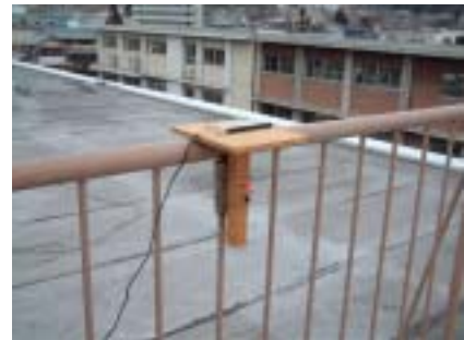
図 21-2 屋上の太陽電池
